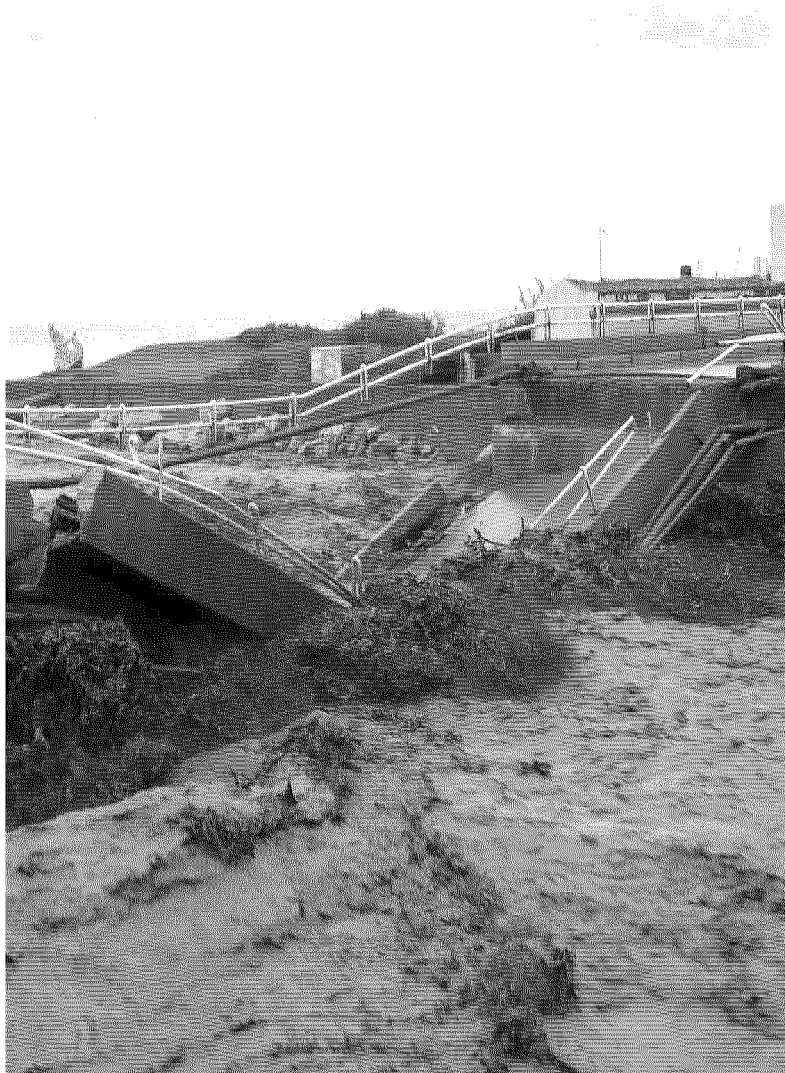
Messina, il ponte che collega Calderà e Spinesante crollato a causa delle forti piogge
